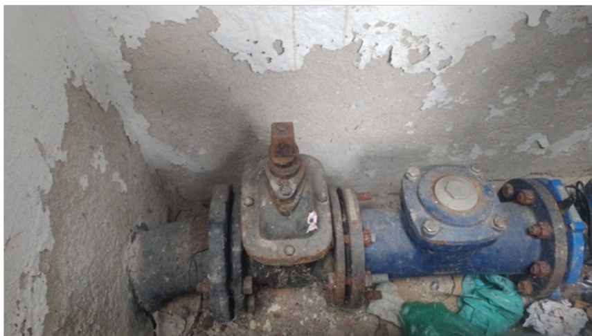
Foto 11 – Válvula antes hidrômetro
