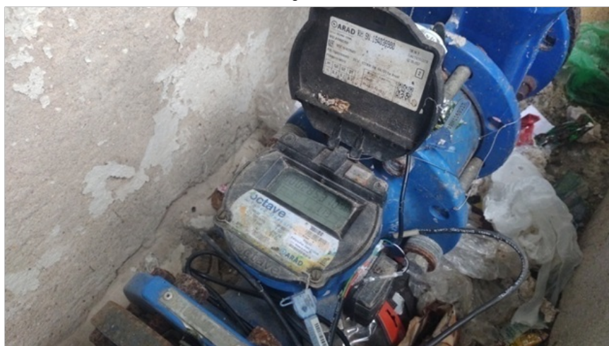
Foto 13 - Hidrômetro Digital marcando vazão 1,13 m³/h
