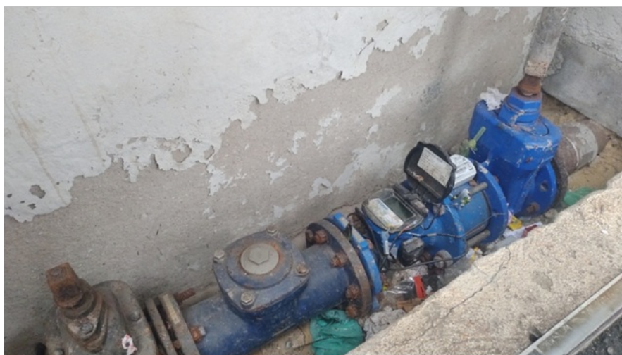
Foto 10 – Hidrômetro Sacadura Cabral
