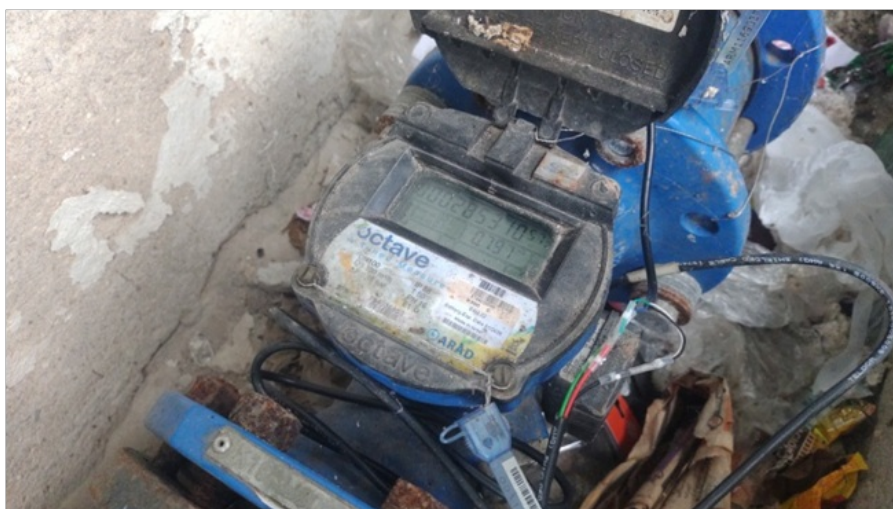
Foto 12 – Hidrômetro digital marcando vazão 0,79 m³/h
